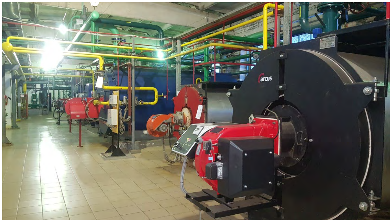
Рисунок 7.19 Котельный зал кот. №3
