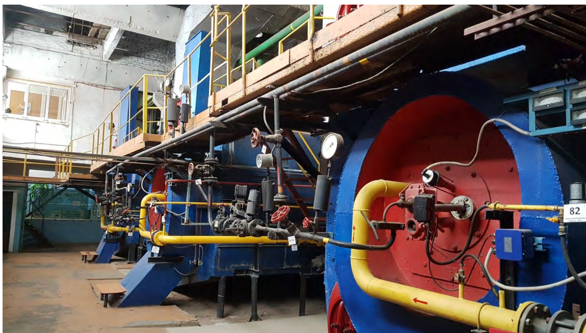
Рисунок 7.9 Котельный зал кот.№1
