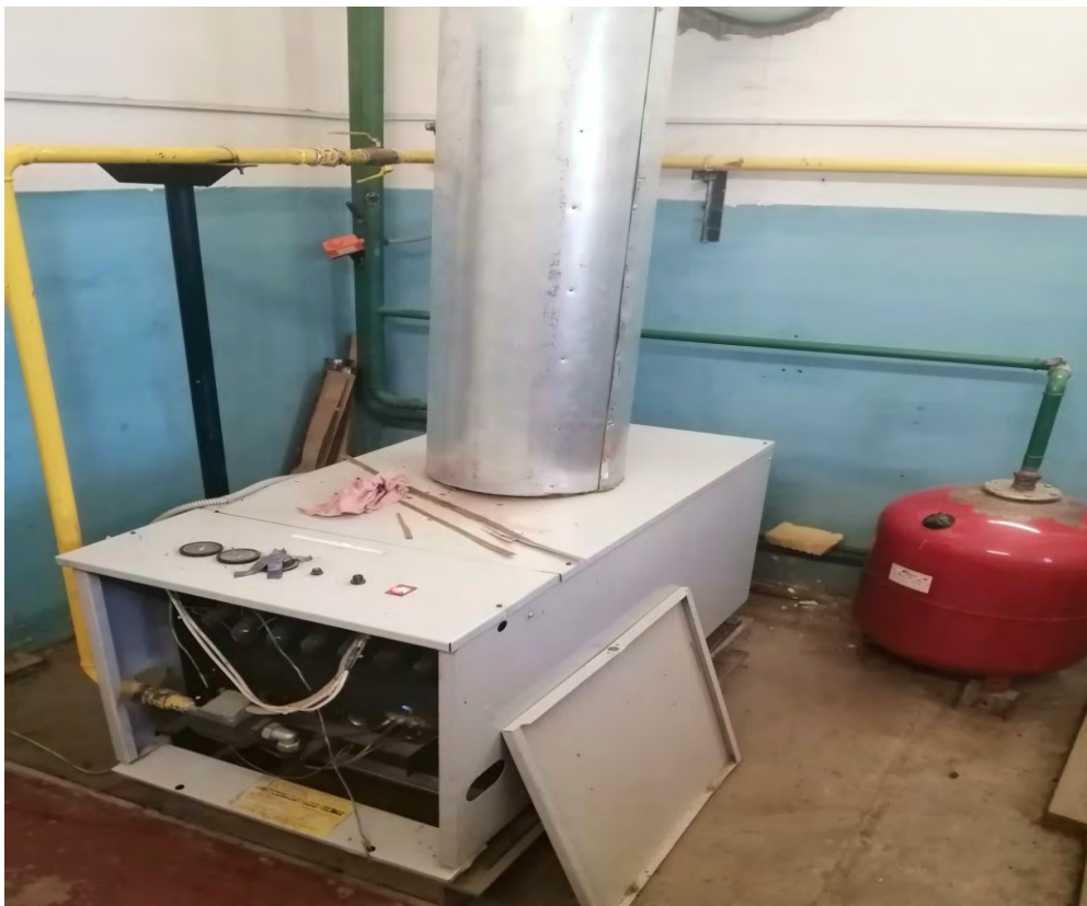
Рисунок 7.55: Оборудование ЦТП-5 (газовый котел мощностью 0,08 Гкал/ч, предназначен для выработки тепловой энергии (подогрев ГВС) для нужд физкультурно-оздоровительный комплекс «Плавательный бассейн».
