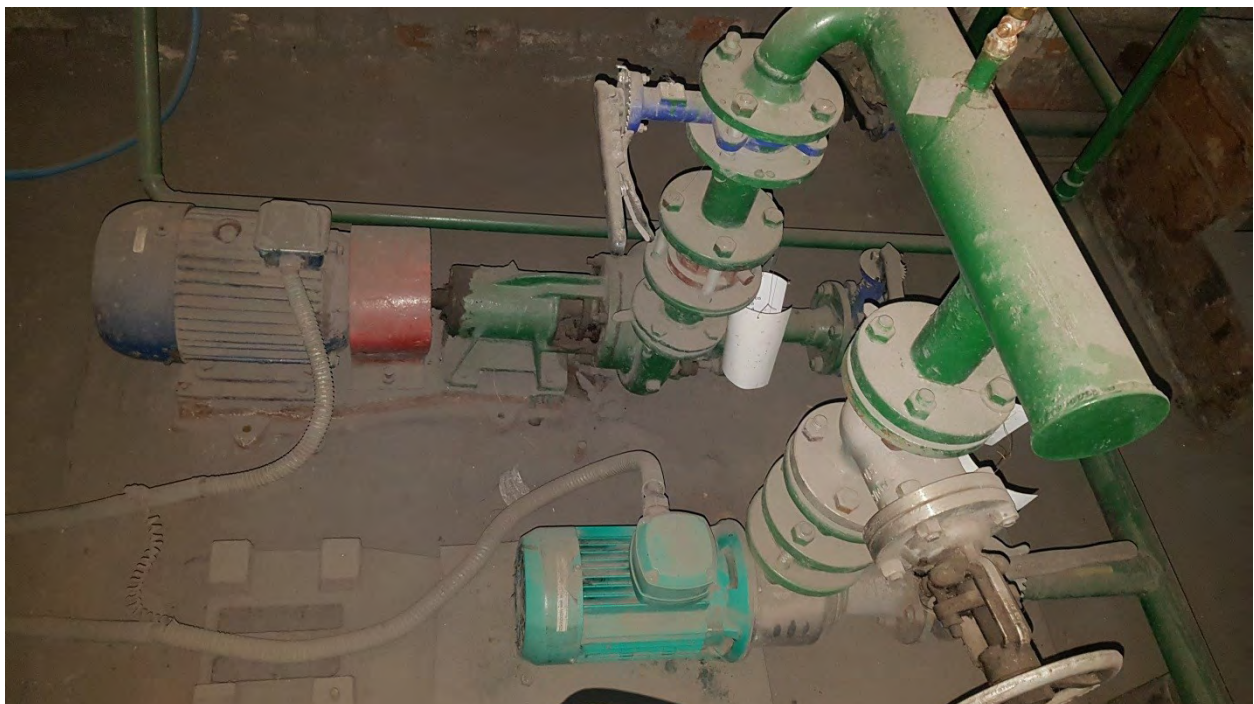
Рисунок 7.41 – Сетевое насосное оборудование
