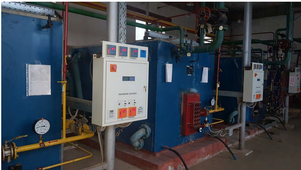
Рисунок 7.21 Котельный зал кот. №5
