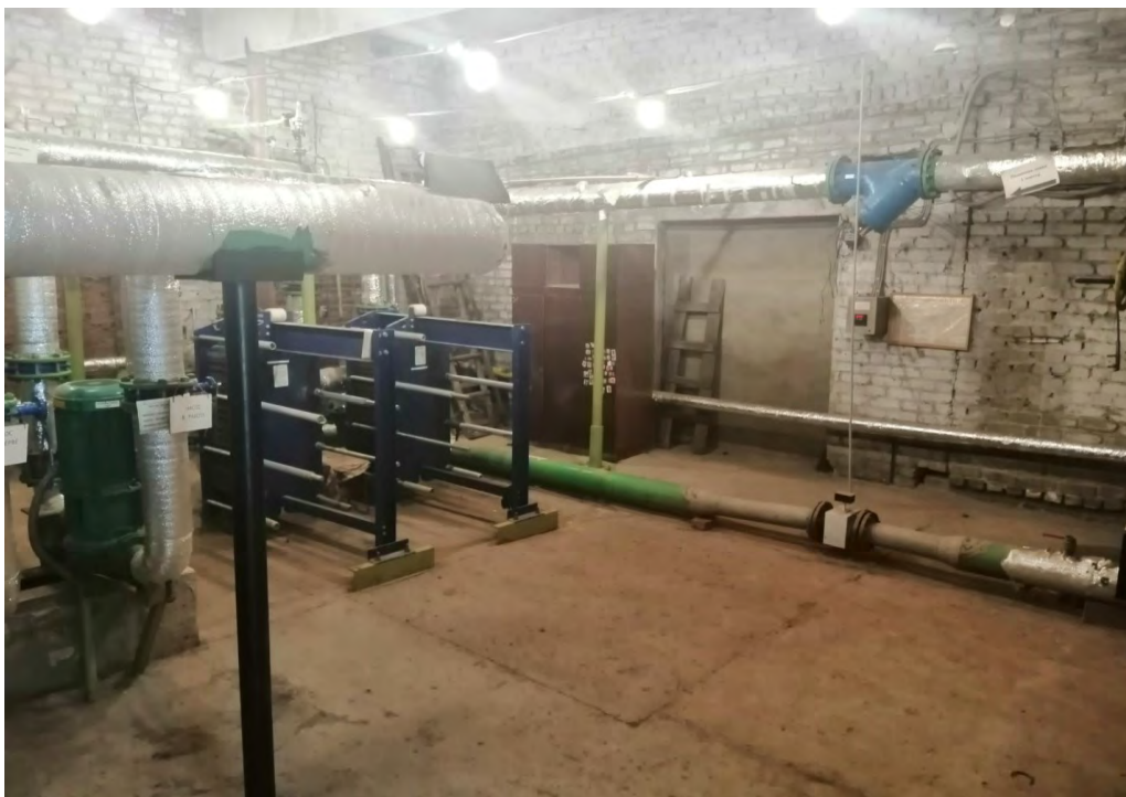
Рисунок 7.70: Теплообменное оборудование ЦТП-4
