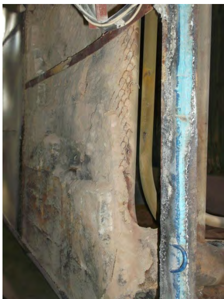
Рисунок 7.11 Состояние обмуровки котла ДЕ-16 № 2
