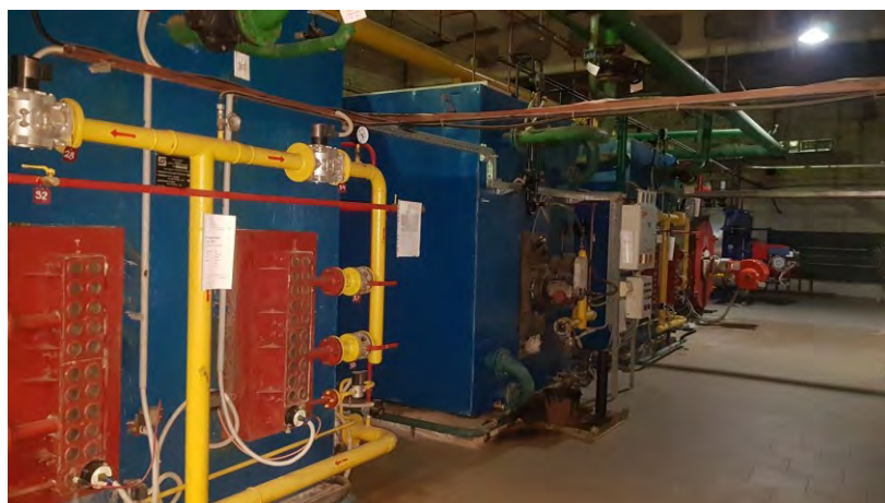
Рисунок 7.20 Котельный зал кот. №4
