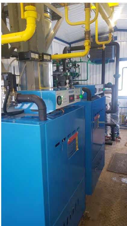
Рисунок 7.24 Котлы на котельной №8
