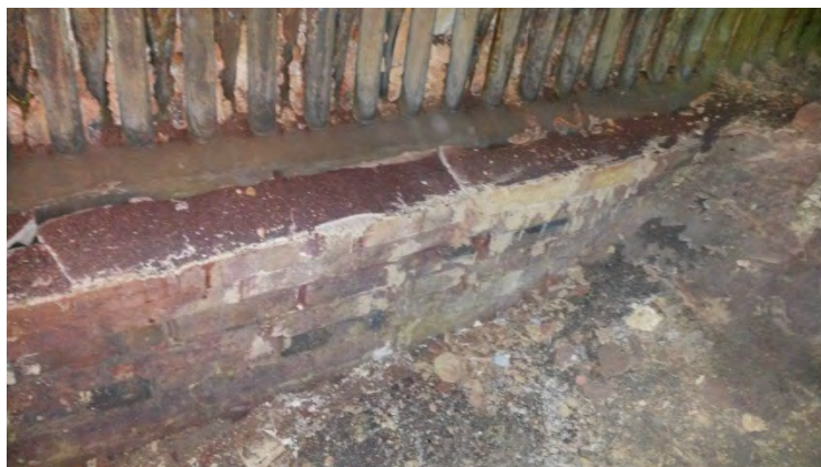
Рисунок 7.12 Состояние топочной стенки котла КЕВ-10 Г №4
