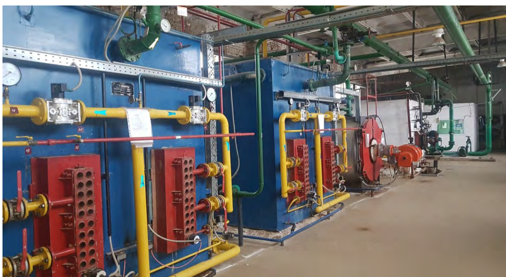
Рисунок 7.22 Котельный зал кот. №7
