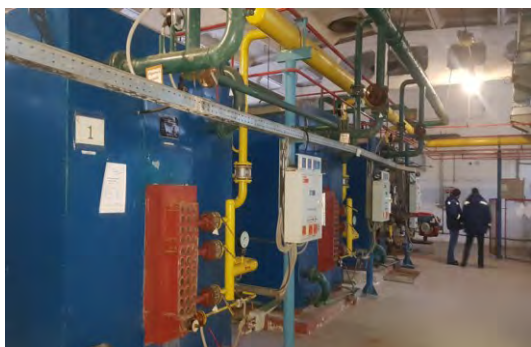
Рисунок 7.18 Котельный зал кот. №2
