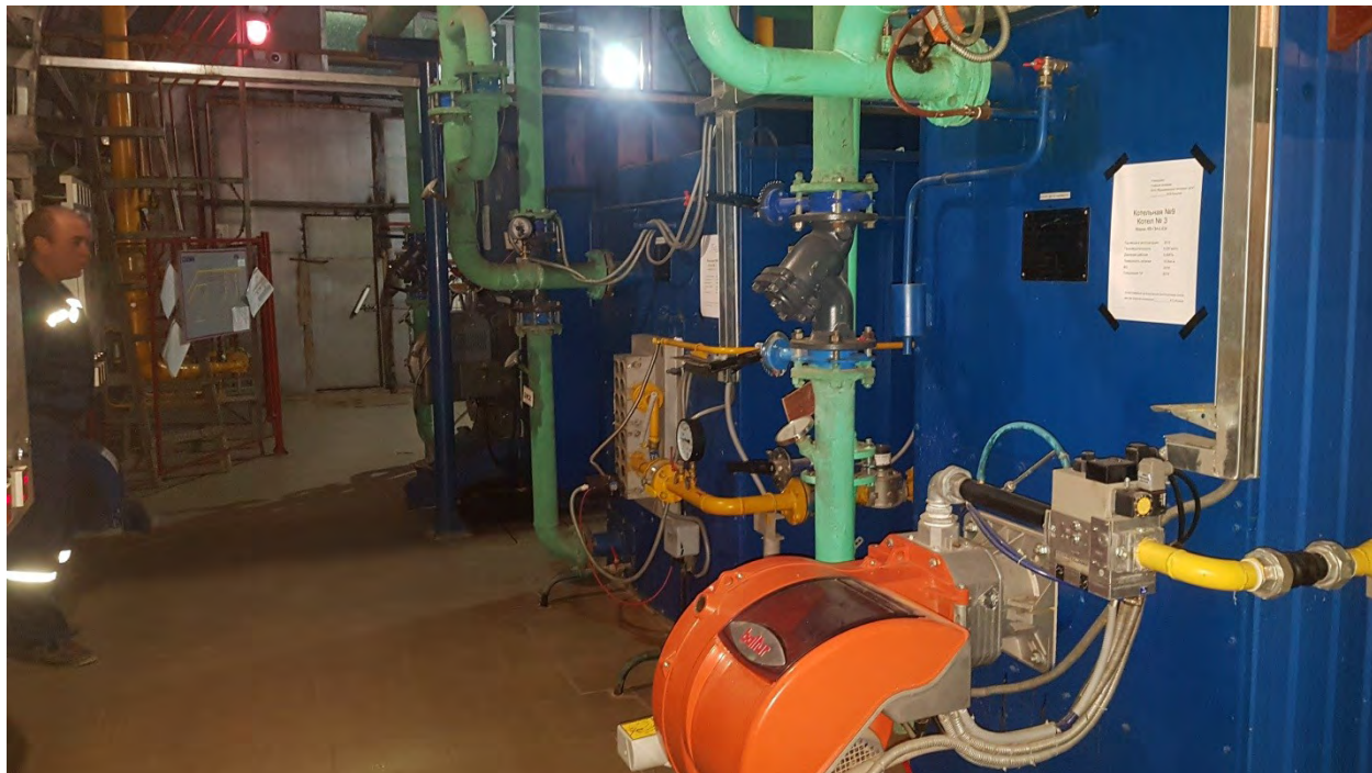
Рисунок 7.25 Котельный зал кот. №9
