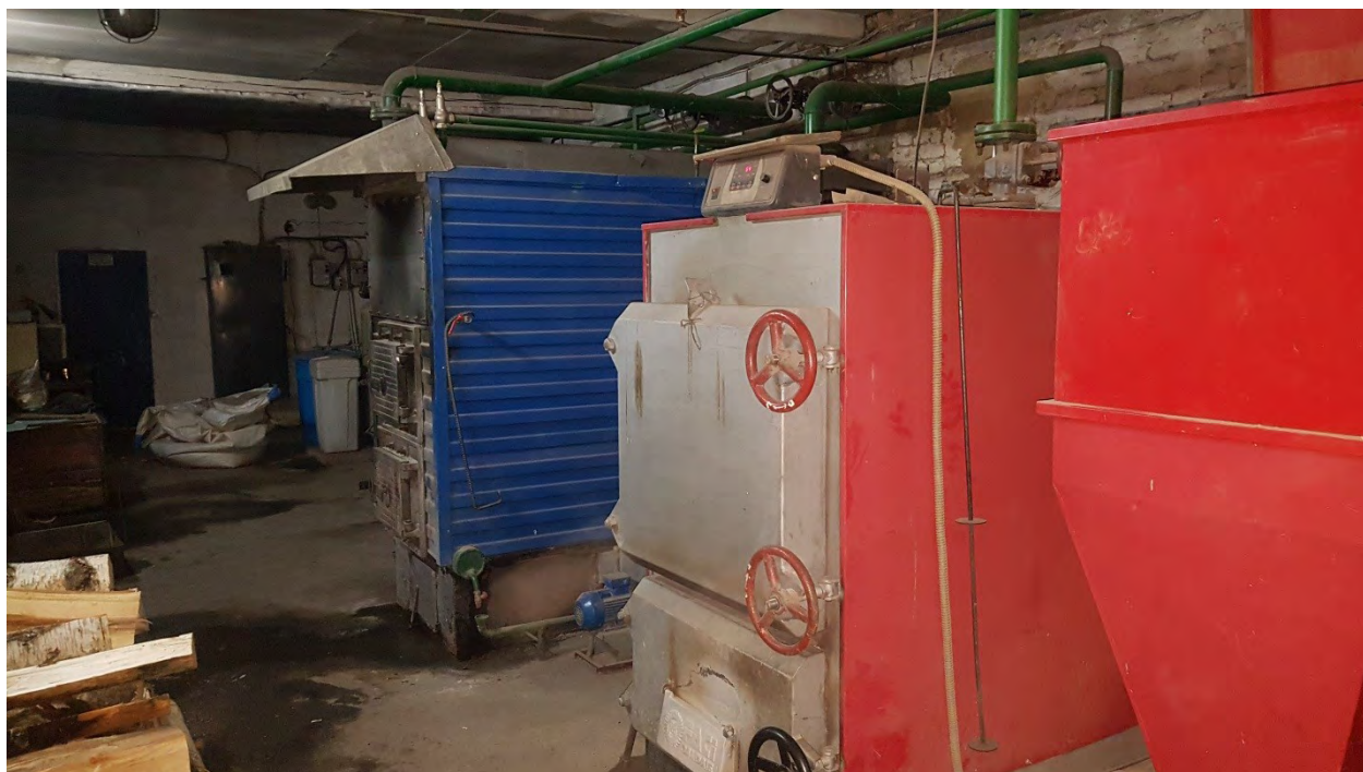
Рисунок 7.26 Котельный зал кот. №10
