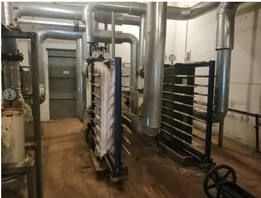
Рисунок 7.75: Теплообменное оборудование ЦТП-2
