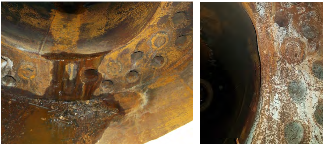
Рисунок 7.23 Состояние дымогарных труб и трубной доски котла Ква-1,25 ГМ
