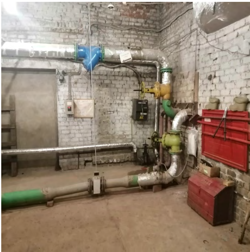
Рисунок 7.71: Приборы учета тепловой энергии, пожарный щит ЦТП-4
