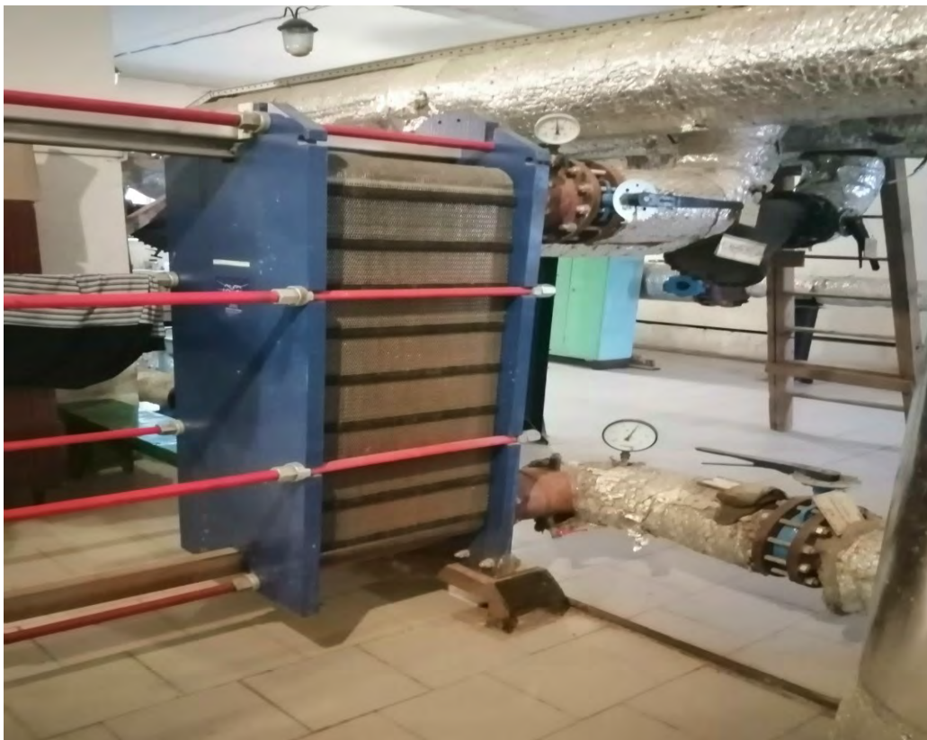
Рисунок 7.58: Теплообменное оборудование ЦТП-5
